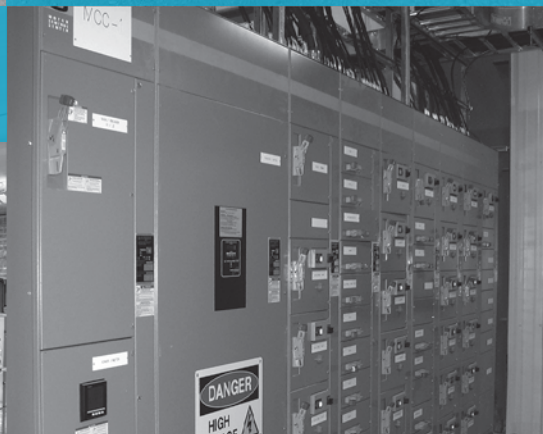
LV SWITCHGEAR & RETROFITS
